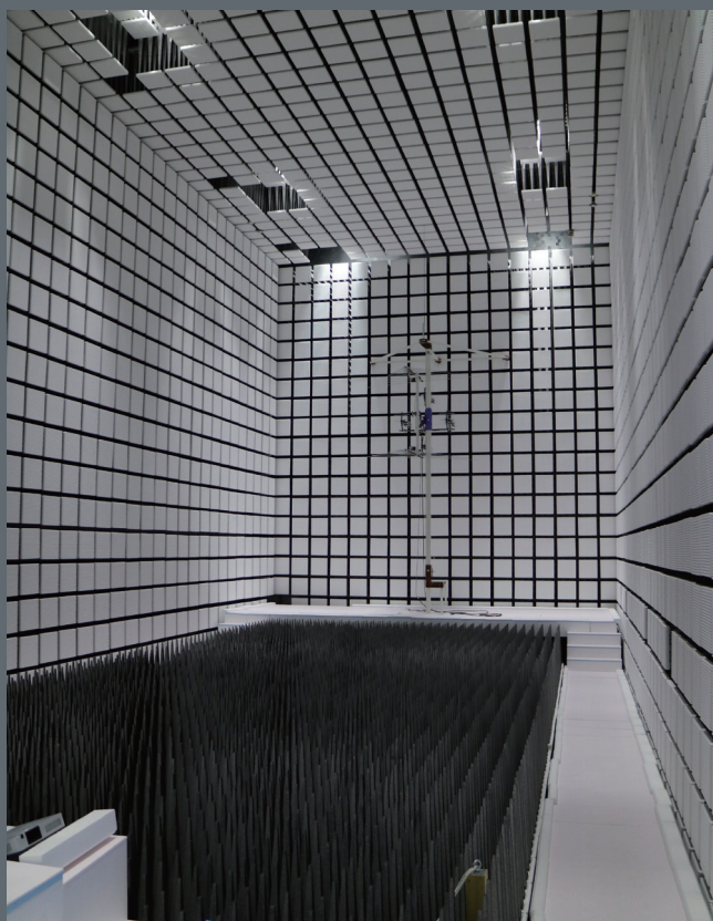
大型電波暗室
